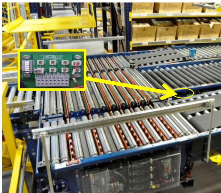
Ubicación general del conector de la PCB en la plataforma de ingreso.
